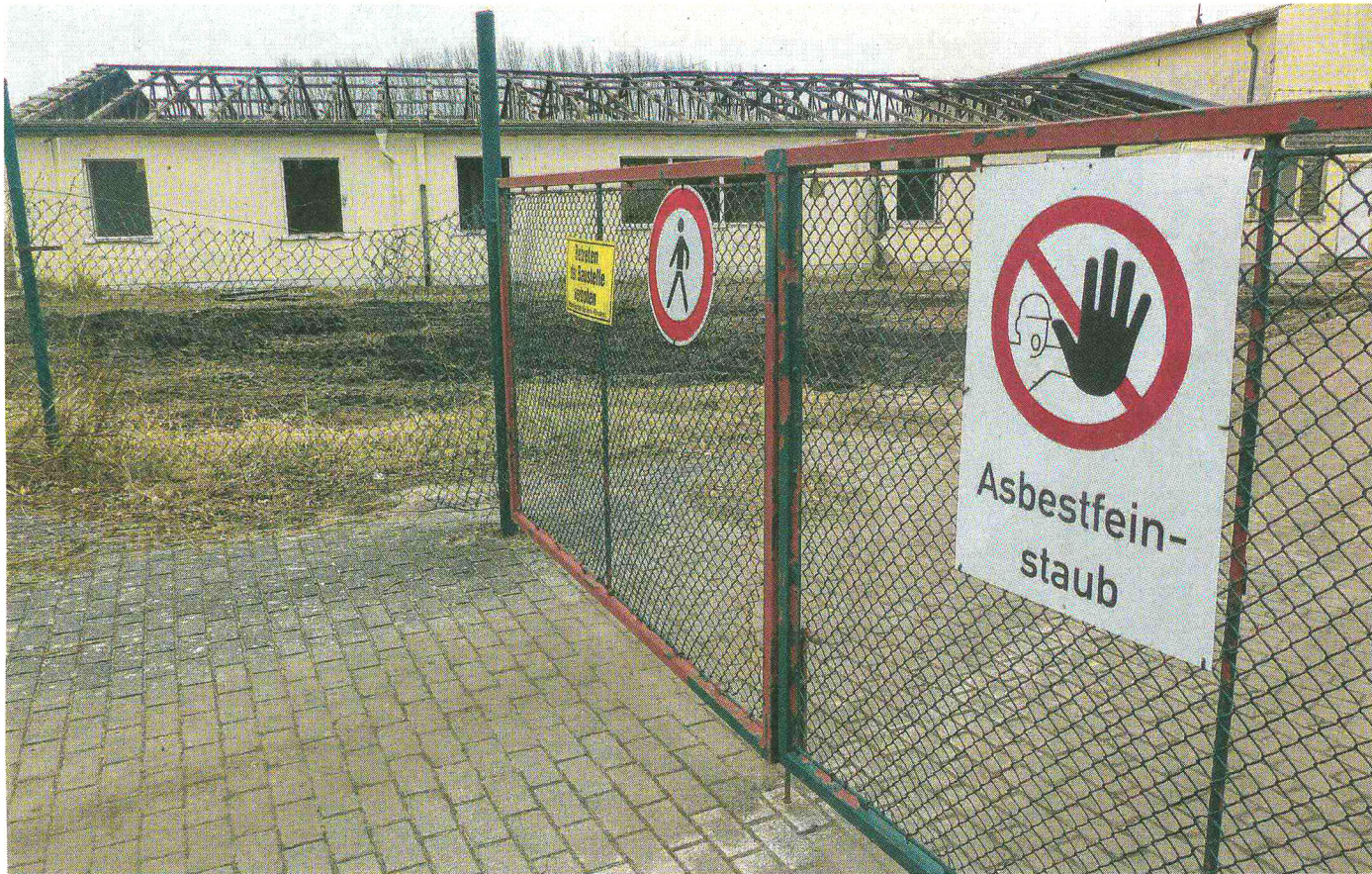
Der Abriss der JVA Ueckermünde im Ortsteil Berndshof hat begonnen. Schilder warnen vor Asbeststaub.
